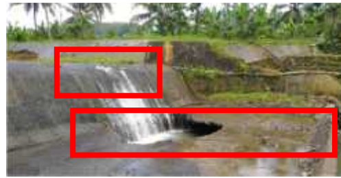
Gambar 2 Kerusakan Bendung Way Padang Ratu I 2022 (sumber : Survey lapangan, 2022)
