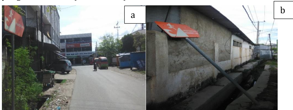
Gambar 3 Jalur evakuasi; a. Rambu tidak jelas arah evakuasinya, b. Rambu sudah roboh
